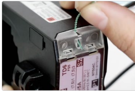
Le scellement du transformateur est réalisé une fois le couvercle couvre-bornes en place.
