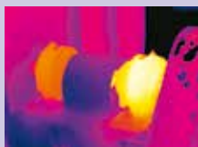
Surchauffe d'un chapeau de palier
